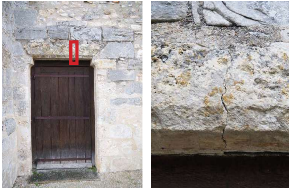
Fissuration du linteau de la porte méridionale - fissure de 1 à 2mm
