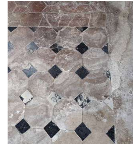
Cabochoon brisé - altération légère par dépose de mortier et contamination de sel
