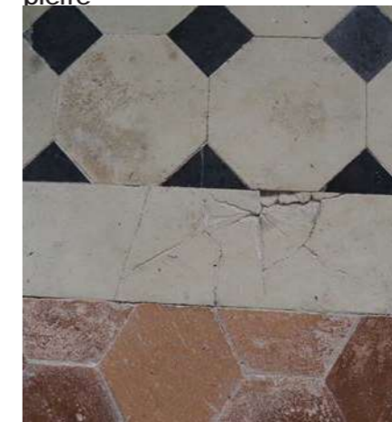
Fissure d'impact sur dalle en pierre
