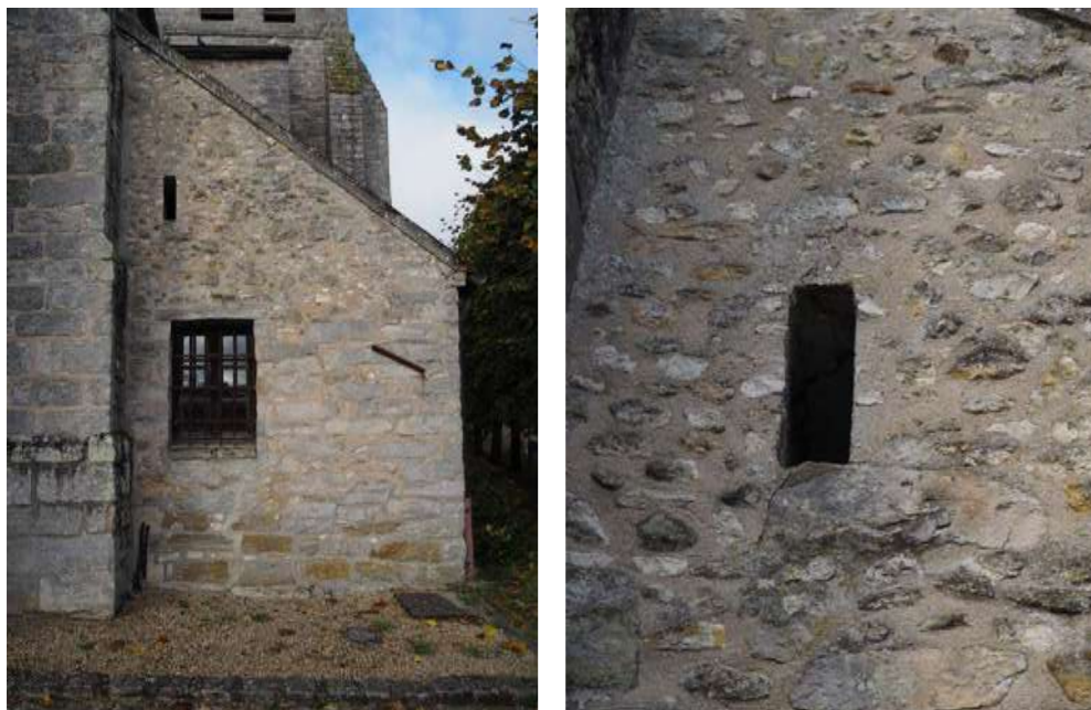
Fissuration de la sacristie - fissure de 1 à 2mm
